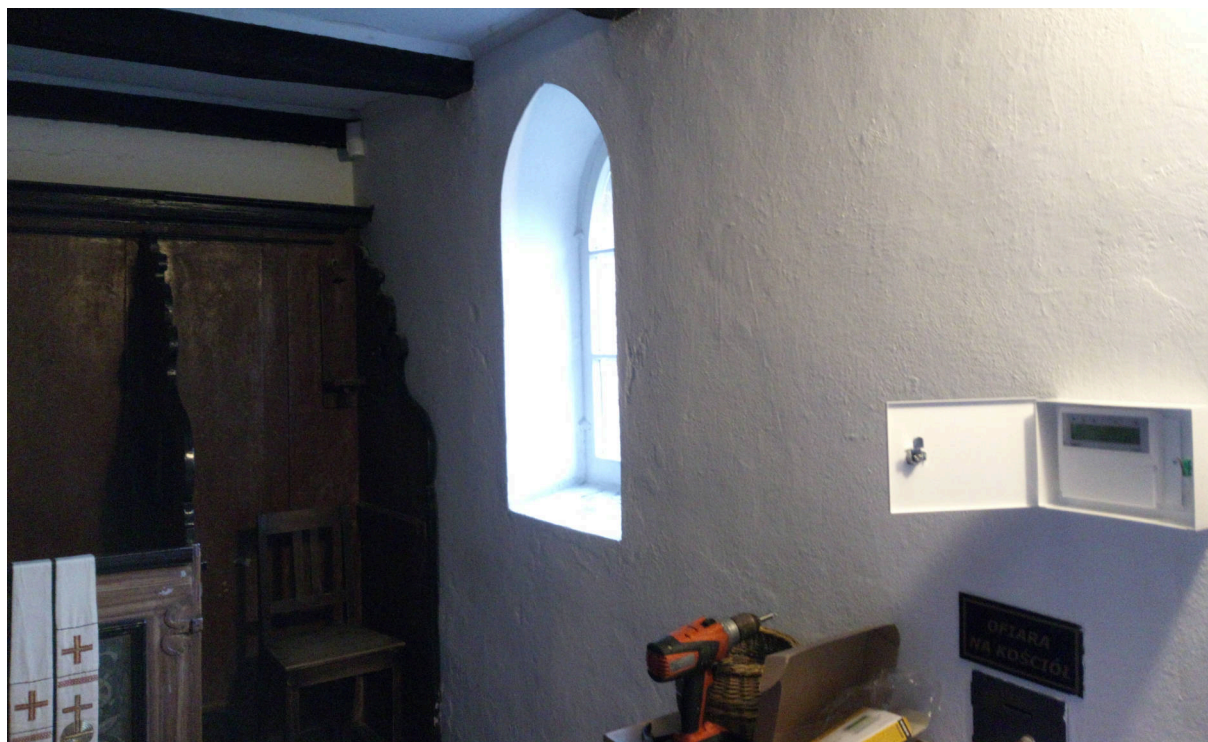
Foto. 1. Widok wnętrza kościoła w trakcie budowy strefy kontroli dostępu z wykorzystaniem czujki strefowej. Źródło: Krzysztof Urzędowski Beta Security System Sp. z o.o. Opole
